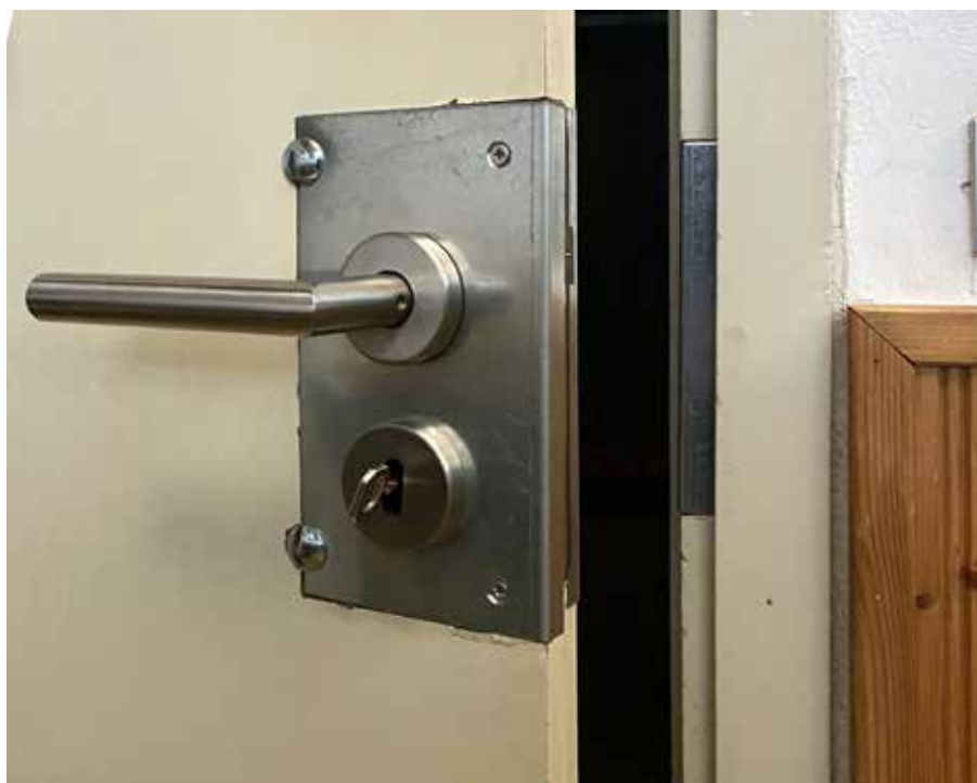
La nuova serratura della porta della segreteria, voluminosa per mascherare il danno fatto dalla forzatura della precedente
